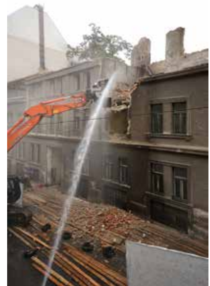
Abbruch eines Altbaus der 1920er-Jahre. Oft ist die Restaurierung aufgrund des engen Korsetts des MRG finanziell nicht möglich. Eine nachhaltige Stadtentwicklung ist so schwierig.
